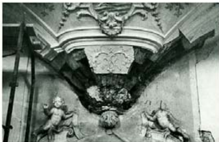
Fuß der Empore nach Abnahme der gefährdeten Partien des Stuckdekor
