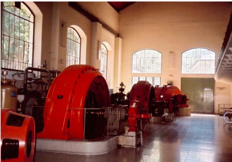
Wienerbruck, Turbinenraum des Kraftwerks
